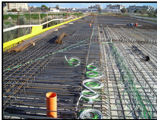
Fig. 13 – Sistemazione dei cavi di collegamento dei sensori lungo le campate del viadotto
