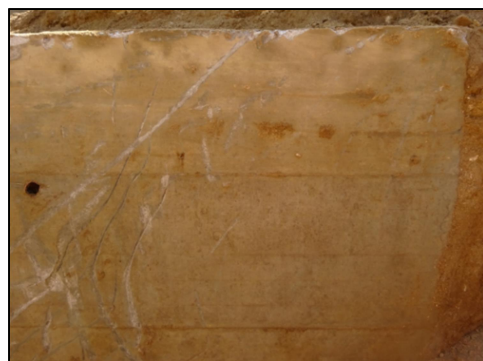
Figura 26-Esempio 2, livello minore di danno
