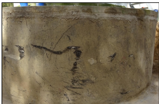
Figura 25-Esempio 2, livello minore di danno
