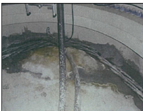
Figura 13-Insedimento di acqua e fango nell'intorno della giunzione [14]
