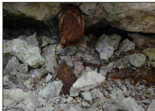
Figura 23- Esemplio 1, rottura barre di fondazione
