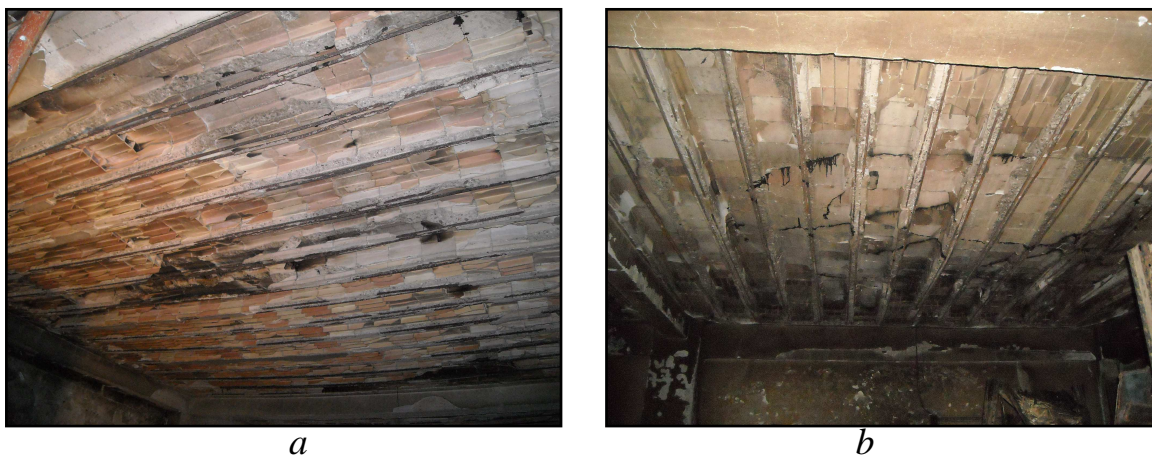
Fig. 1. a,b – Stato di danneggiamento dei solai
